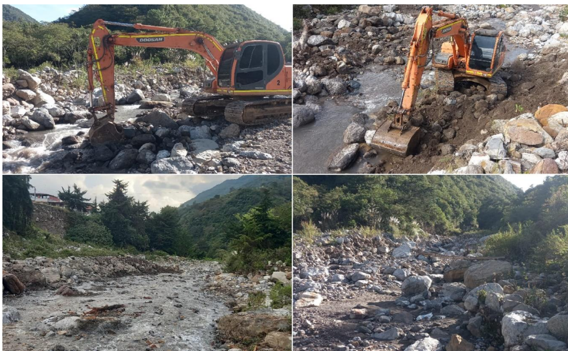
Intervenciones con maquinaria amarilla en los municipios de El playón, Rionegro, Vetas, Suratá
